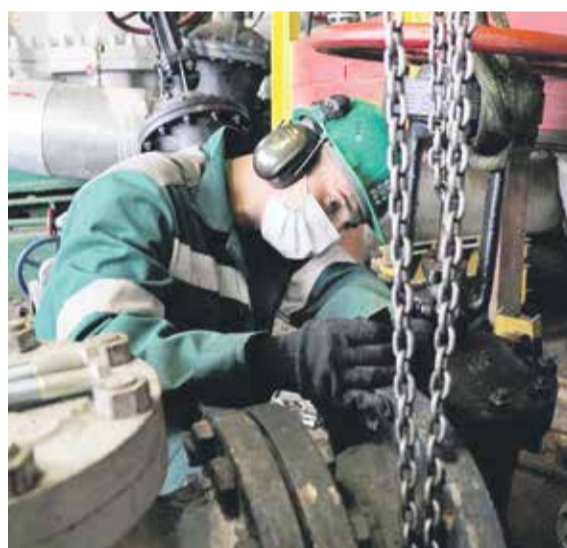
Данил Ундровский, слесарь по ремонту оборудования тепловых сетей ЦПВСИТК, готовит задвижки к зиме
